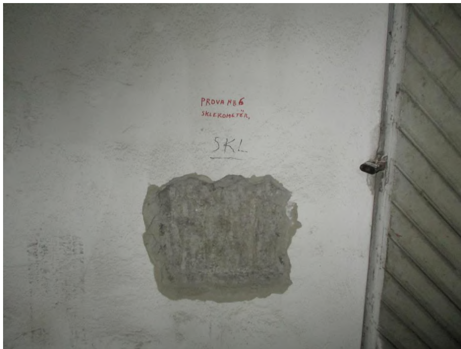
Fig 13. Pozicioni Nr. 6, Element betoni (mur ose kolonë) në aksin K ndërmjet aksit 5 dhe 6, Kati -1
