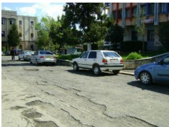
Figura 4-7 Shtresa asfaltike të dëmtuara të sheshit
