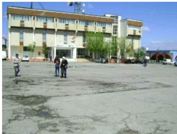
Figura 4-8 Shtresa asfaltike të dëmtuara të sheshit
