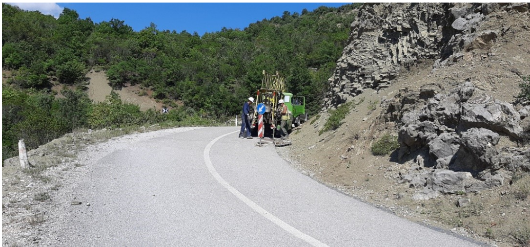
Foto Nr.4 Ne piken ku eshte bere shpimi BH-22 ne km 21+120 duken renia e dherave ne trupin e rruges dhe skarpata eshte ne gjendje kritike
