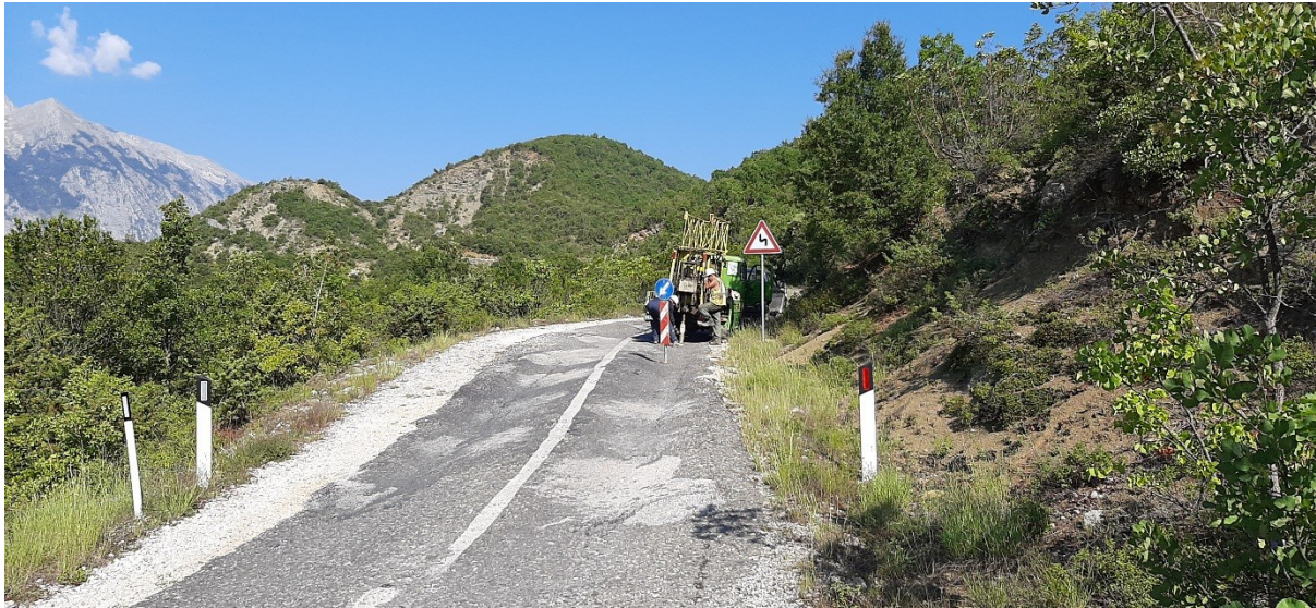
Foto Nr.11 Rruga ne km 24+970, ka pesuar ulje te bazamentit dhe prishje te shtresave te rruges
