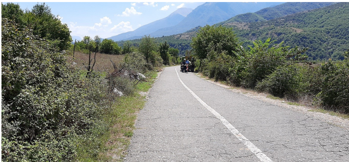
Foto Nr.8 Rruga ne km 14+050 ulje te bazamentit te rruges dhe çarje te asfaltit
