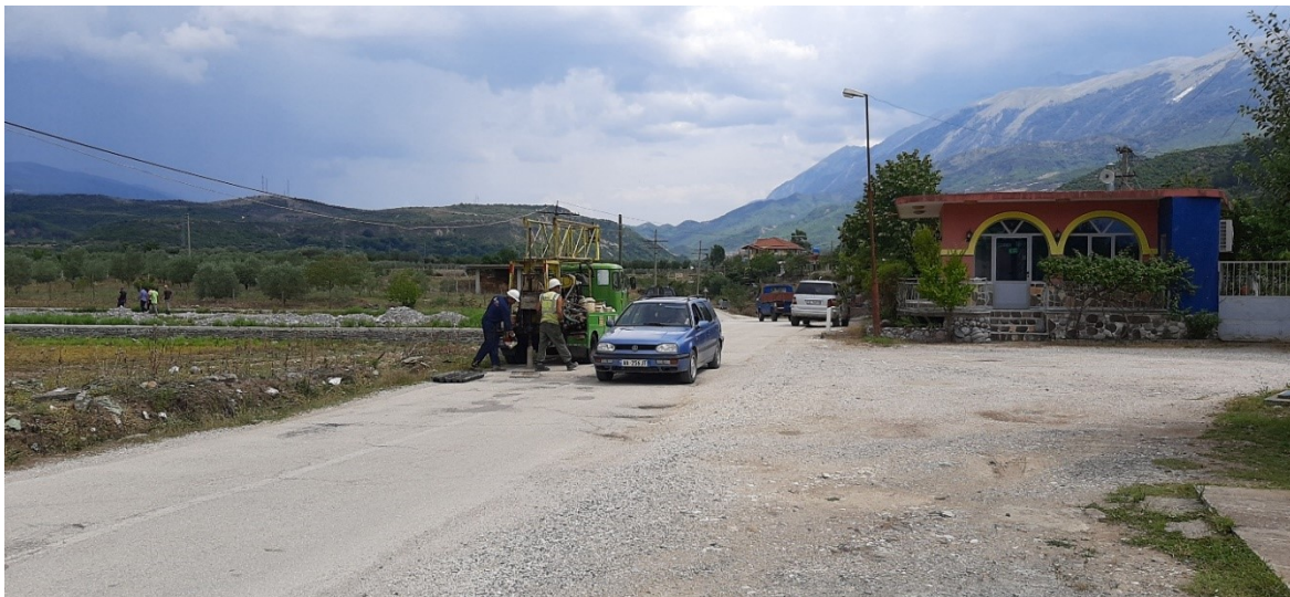
Foto Nr.6 Rruga ekzistuese ne km 0+960, asfalti pothuajse i prishur
