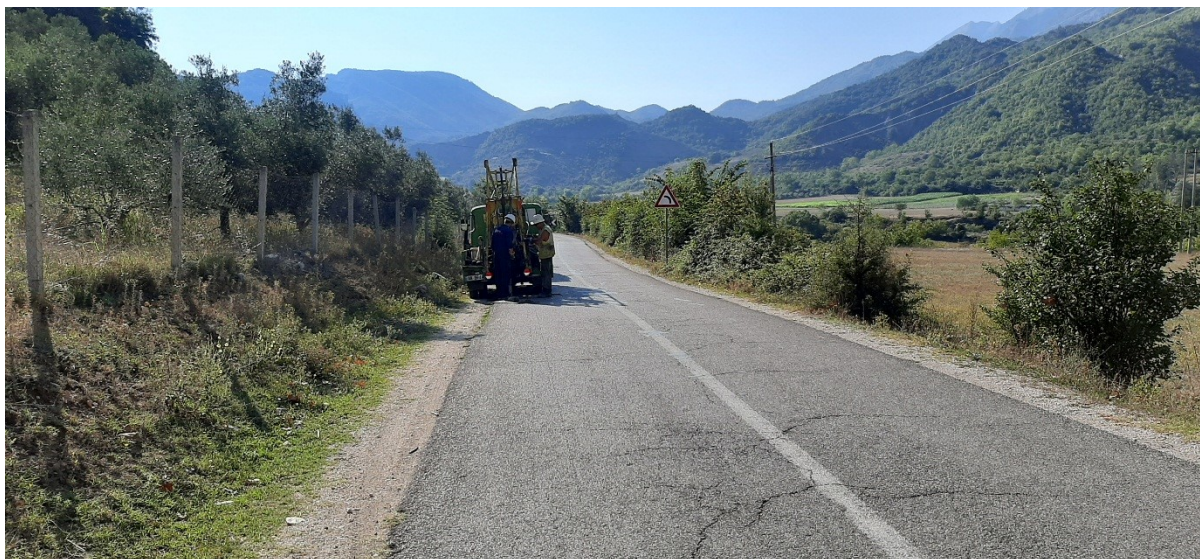
Foto Nr.7 Rruga ekzistuese ne km 4+900 asfalti i çare ne formen e merimanges
