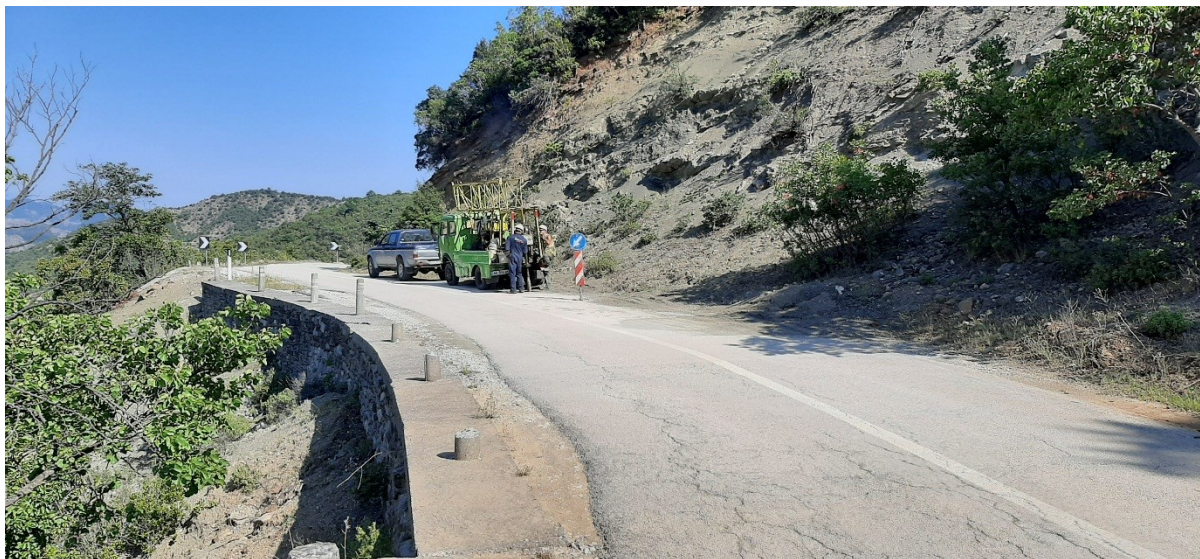
Foto Nr.9 Rruga ne km 23+050, ka pesuar ulje te bazamentit nga ana e mbushur dhe çarje te asfaltit
