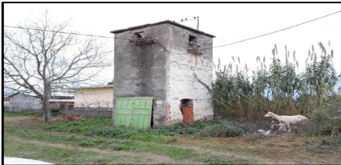
Foto 1: Kabina Murature-Cerme e Siperme 03-Fideri Nr.4/10KV-N/St Bicukas-Divjake 35/10KV
