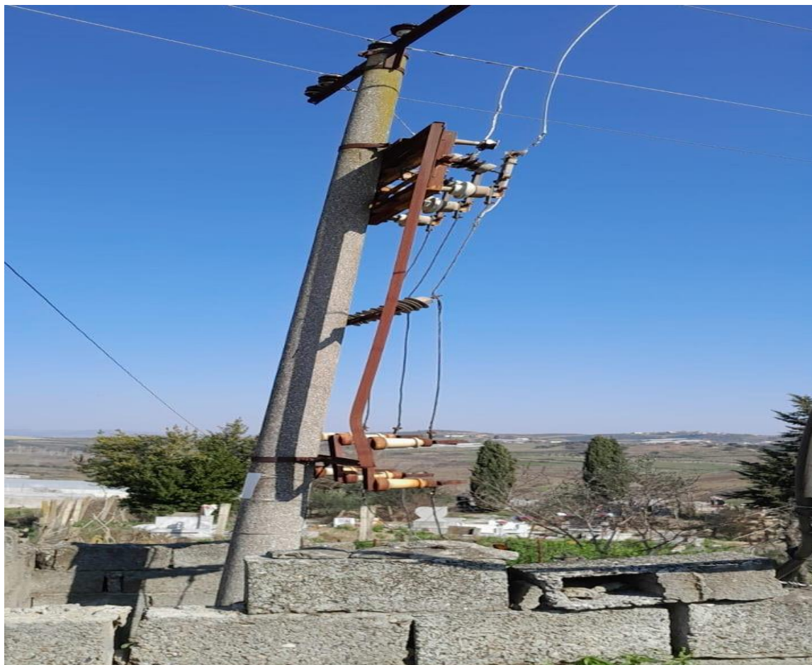
Foto 2: Kabina Shtyllore-Canakaj 01-Fideri Nr.4/10KV-N/St Hyzgjakaj 35/10KV
