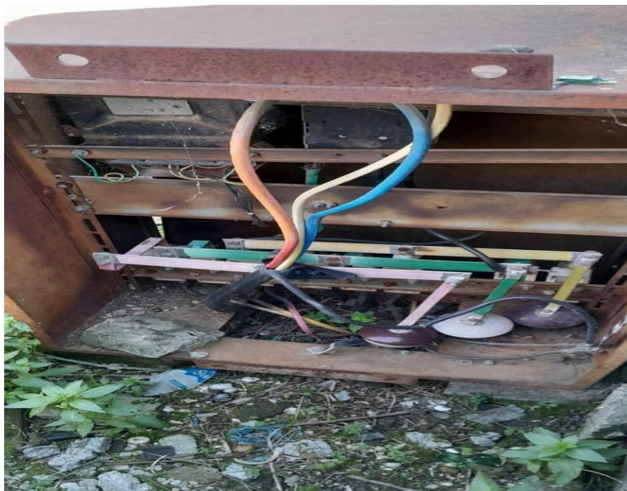
Foto 1: Kabina Shtyllore-Canakaj 01-Fideri Nr.4/10KV-N/St Hyzgjakaj 35/10KV
