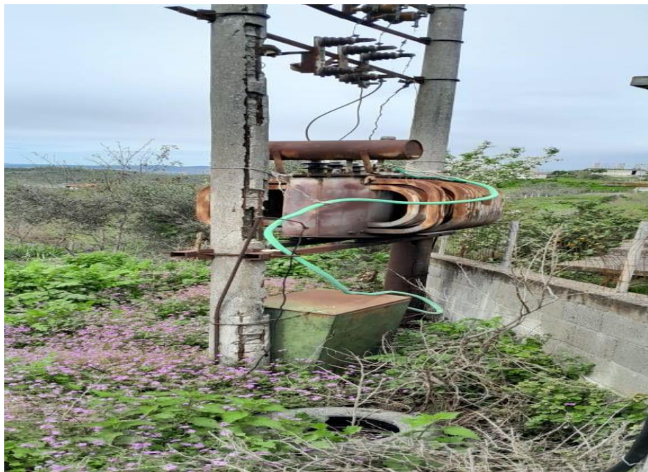
Foto 5: Kabina Shtyllore-Xibrake-Fideri Nr.2/10KV-N/St Hyzgjakaj 35/10KV
