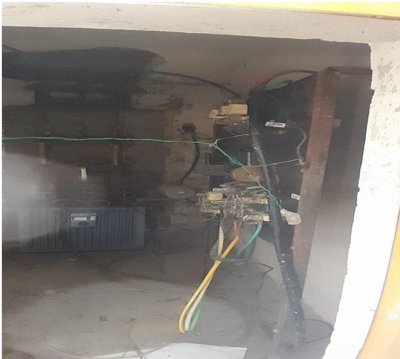
Foto 1: Kabina Murature-Ballagat Qender 03-Fideri Nr.2/10KV-N/St Hyzgjojka 35/10KV
