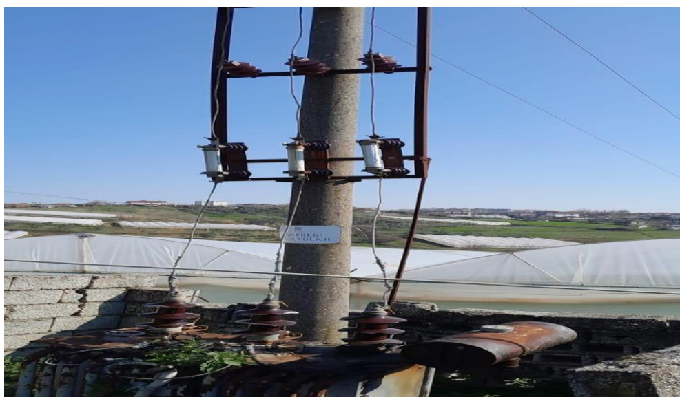
Foto 3: Kabina Shtyllore-Canakaj 01-Fideri Nr.4/10KV-N/St Hyzgjakaj 35/10KV
