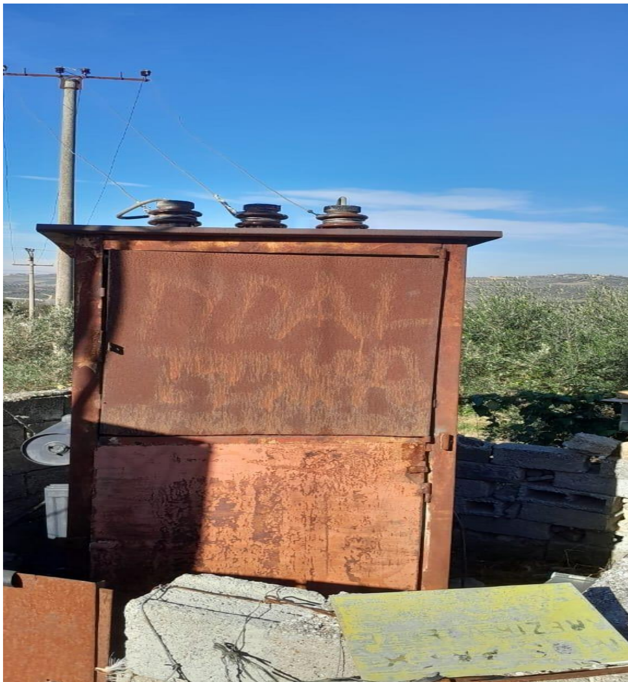
Foto 1: Kabina Metalike-Hyzgjokaj 04-Fideri Nr.4/10KV-N/St Hyzgjokaj 35/10KV
