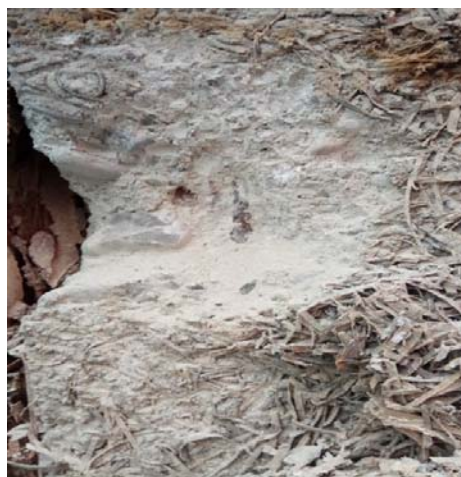
Fig.5 Degradimi i betonit të kolonës
