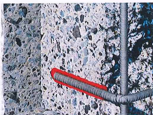
DETAJ I RIPARIMEVE TE MUREVE TE DEMTUARA
