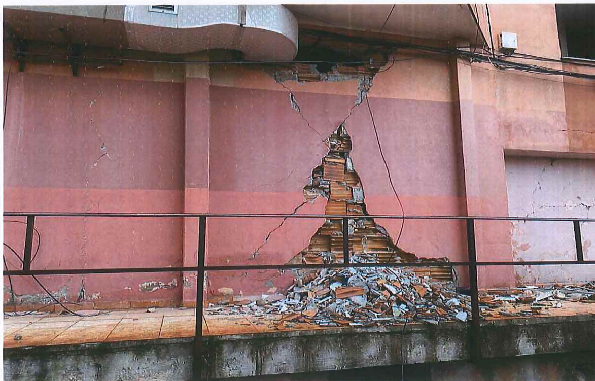
Foto 5. Thyerje te muratures se tulles ne katin perdhe.
