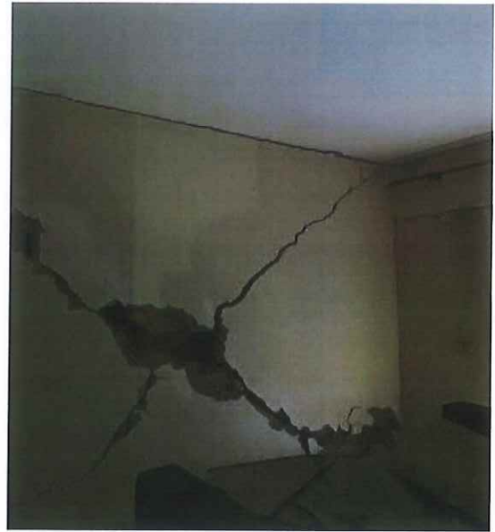
Dëmtim në muraturë
