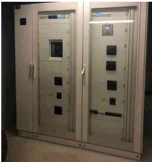
Paneli i shperndarjes se energjise
