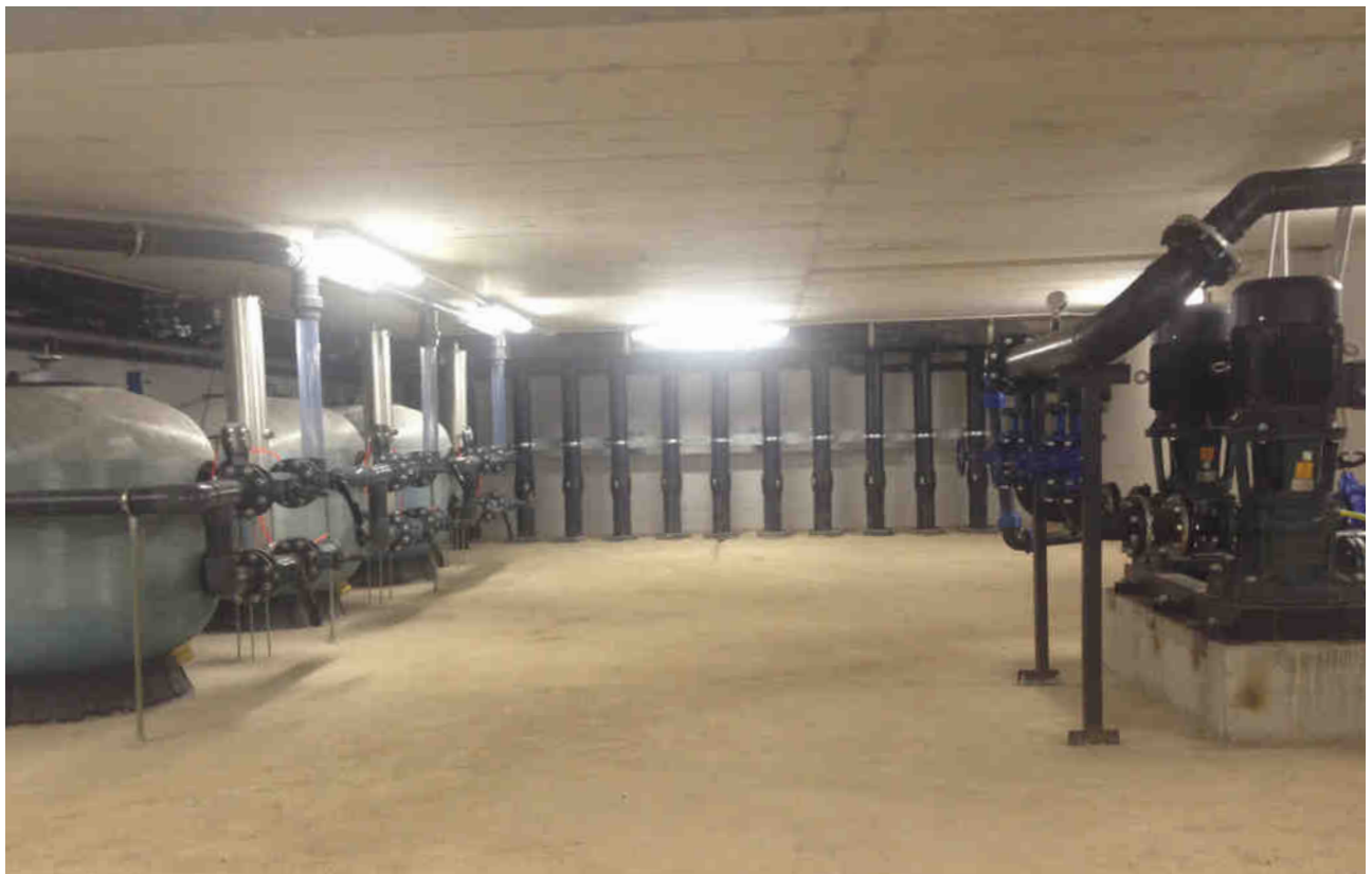
Dhoma e filtrave mekanik, UV dhe pompave te vaditjes
