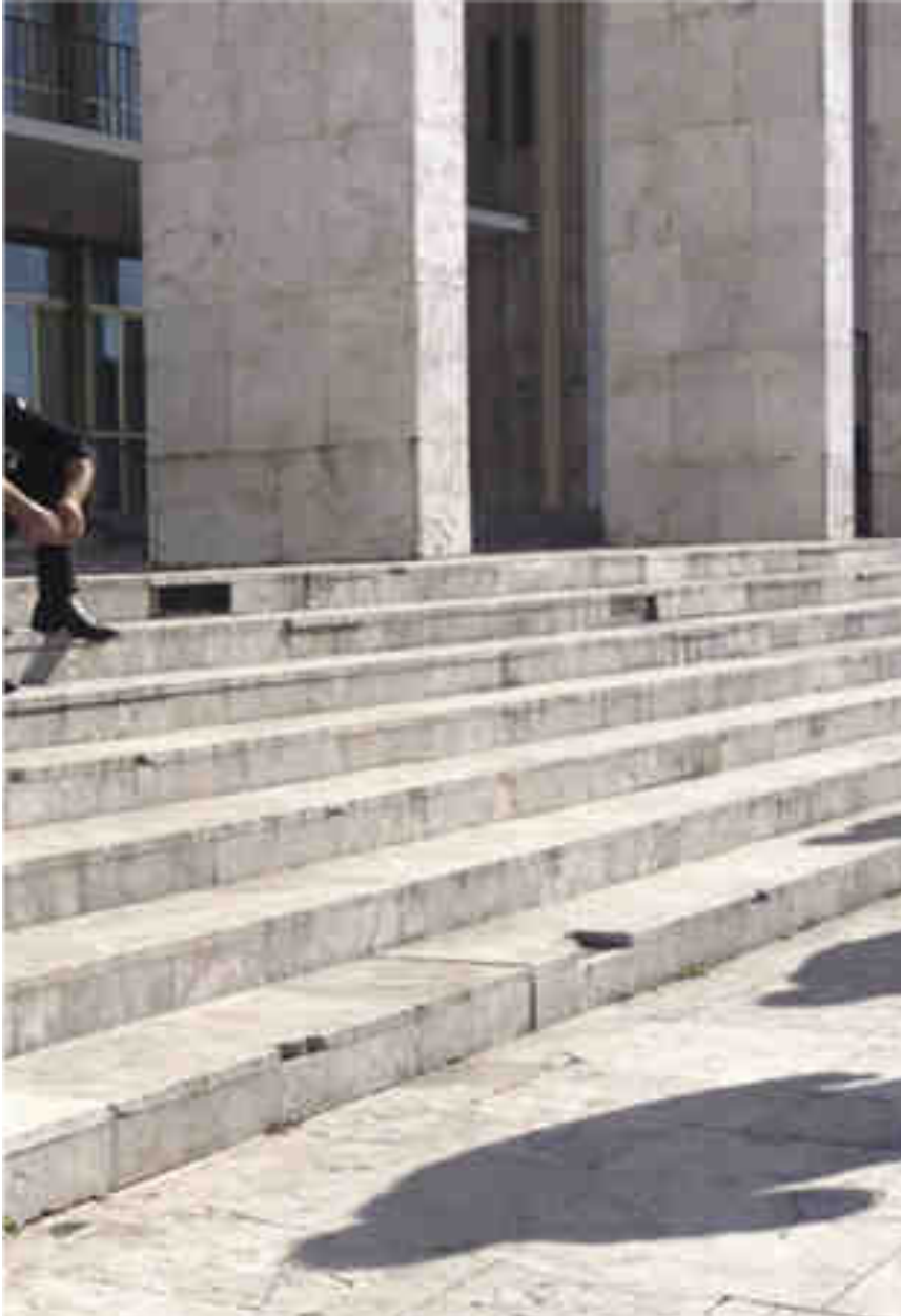
Pllakat e dyshemese dhe të kolonave , foto e 2016
