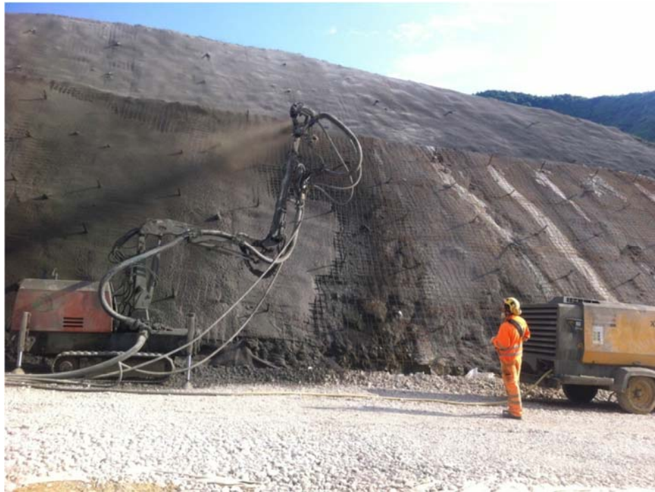
Figura 13- Shembull per punimet e betonit te sprucuar
