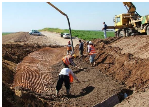
FIGURE 21. DERDHJA E BETONIT
