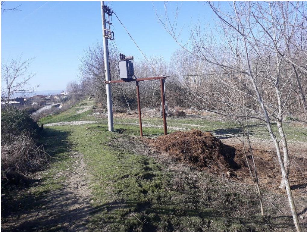
Shtylla e Transformatori I Pompes Egzistuese.
