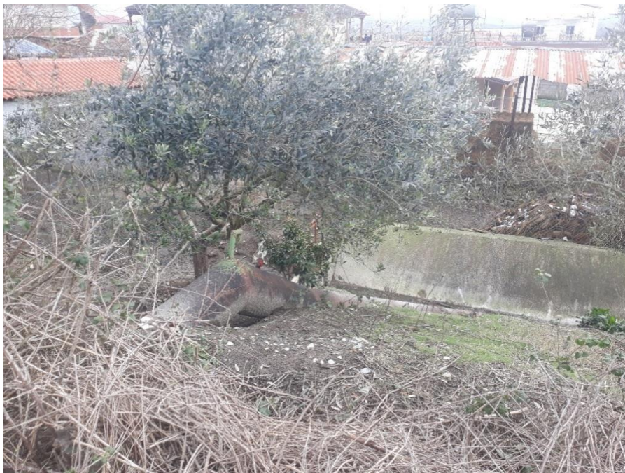
Tubacioni I dergimit , puseta e derdhjes ne kanal.
