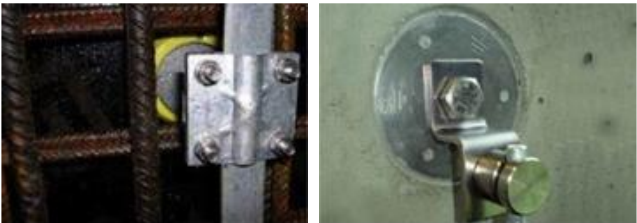
Figura 2. Detaj i fiksimit të shiritit të tokëzimit në zgaren e hekurit për nxjerrjen e terminalit të fiksuar të tokëzimit për tokëzimin e paneleve të matjes
