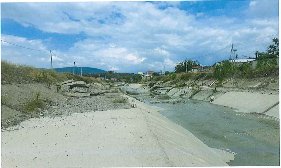
Foto 6. Pamje e prishjeve te bazes dhe skarpatave te shtratit të Zaranikës
