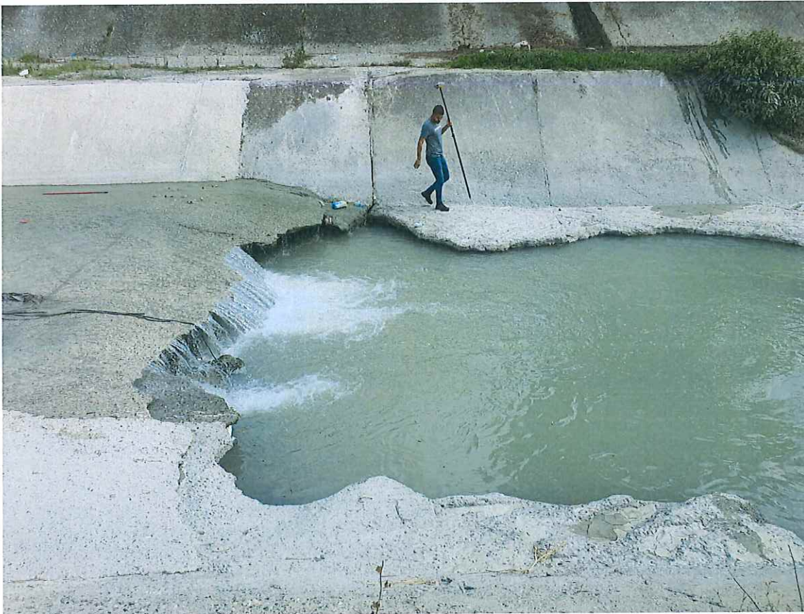
Foto 1. Pamje prishjeve te bazamentit te perroit Zaranike
