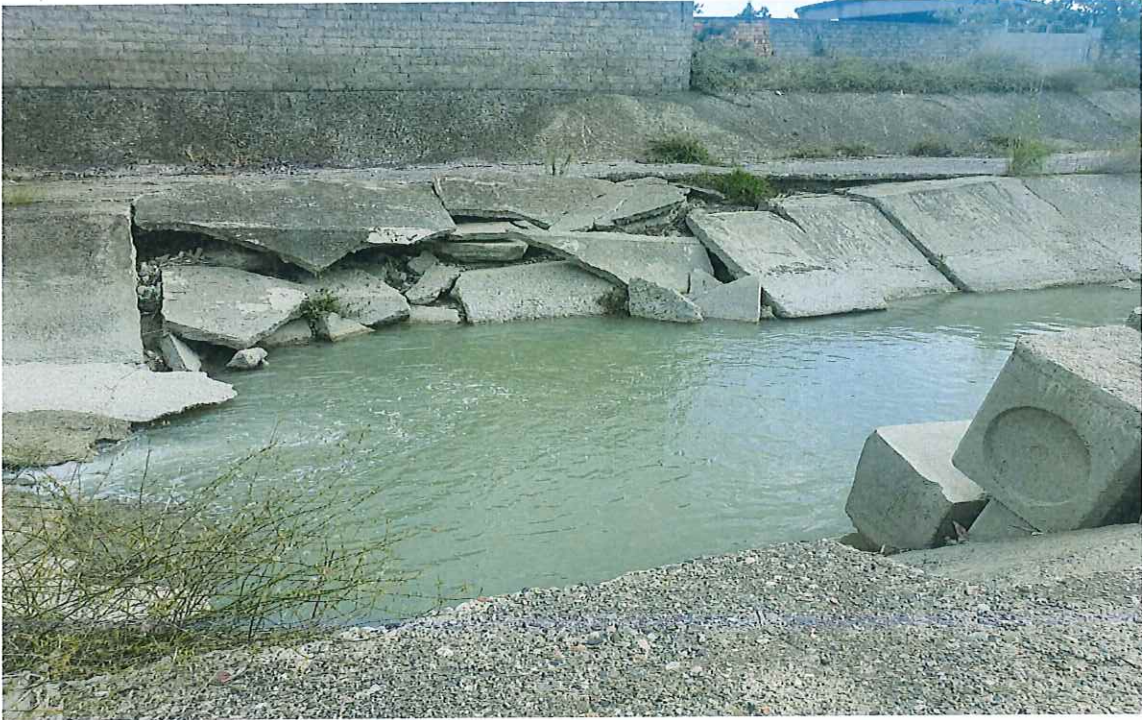
Foto 2. Pamje e prishjeve te bazes dhe skarpatave te shtratit të Zaranikës
