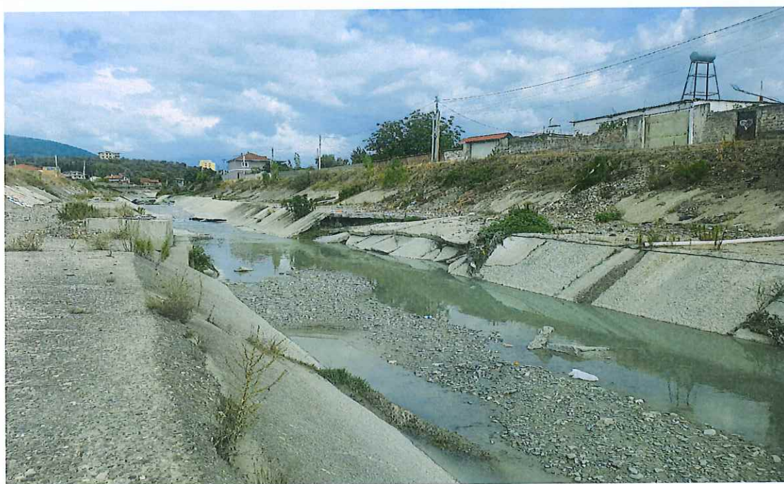
Foto 5. Pamje e prishjeve te bazes dhe skarpatave te shtratit të Zaranikës
