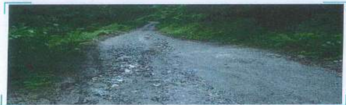
Fotografia 12 : Zgjidhjet për problemin në këtë fotografi janë: largimi i vegjetacionit, ndërtimi i një kanali anësor, mbushja e rrugës me zhavorr, rrafshimi dhe formësimi i profilit të kororës, ngjeshja/pressim
