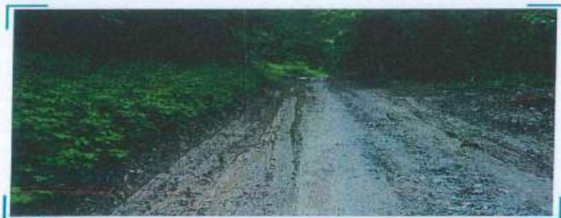
Fotografia 6: Një lug ujëmbledhës prej betoni mardëson kalimin e përroit përmbi rrugë (Fotografia: Juri Begaj)
