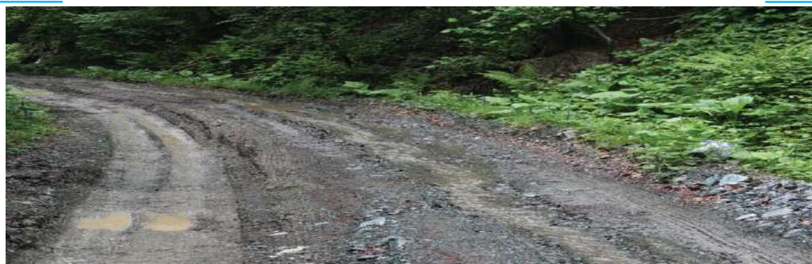
Fotografia 13 : Vraga e rrotave në rrugë si rezultat i kamionëve të stërngarkuar që lëvizin në rrugë me sistem jo të duhur drenazhimi dhe me kapacitet bartës të pamjaftueshëm të shtresës
