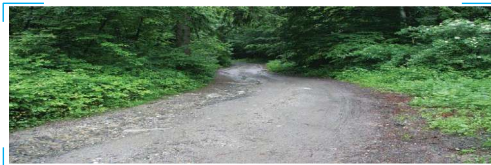
Fotografia 14: Degët e stërvarura duhet të hiqen për të mundësuar që drita e diellit dhe era të depërtojnë në sipërfaqen rrugore në mënyrë që të mundësojnë tharjen e saj.
