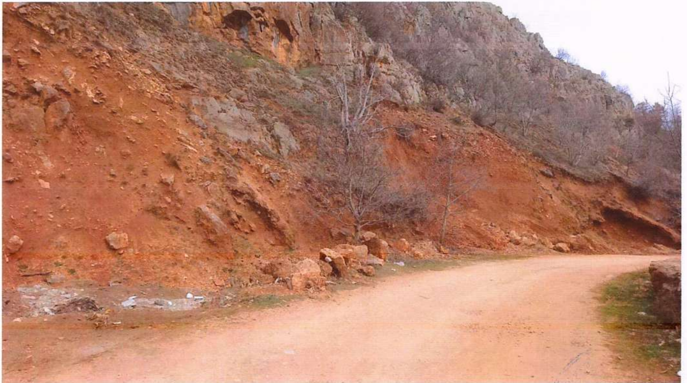
Figura 22 Gjendja ekzistuese e rruges
