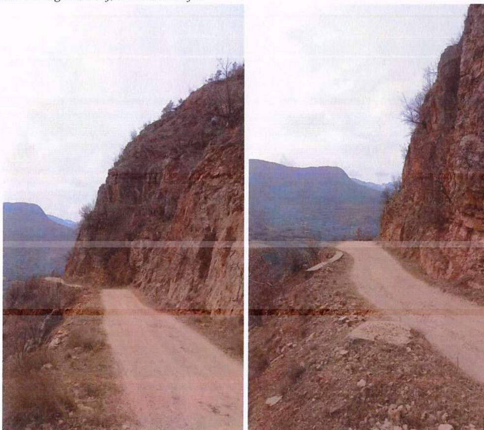
Figura 19 Gjendja ekzistuese e rruges
