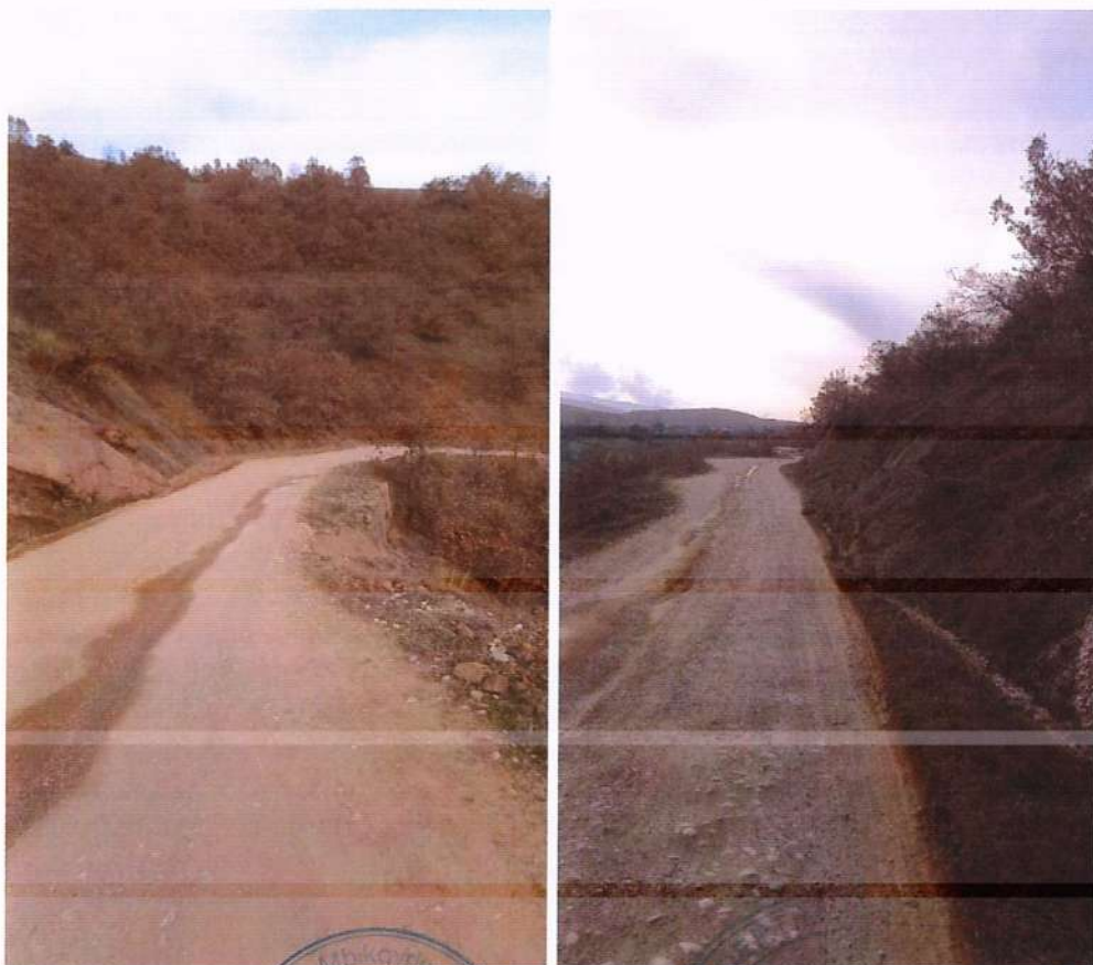
Figura 34 Gjendja ekzistuese e rruges
