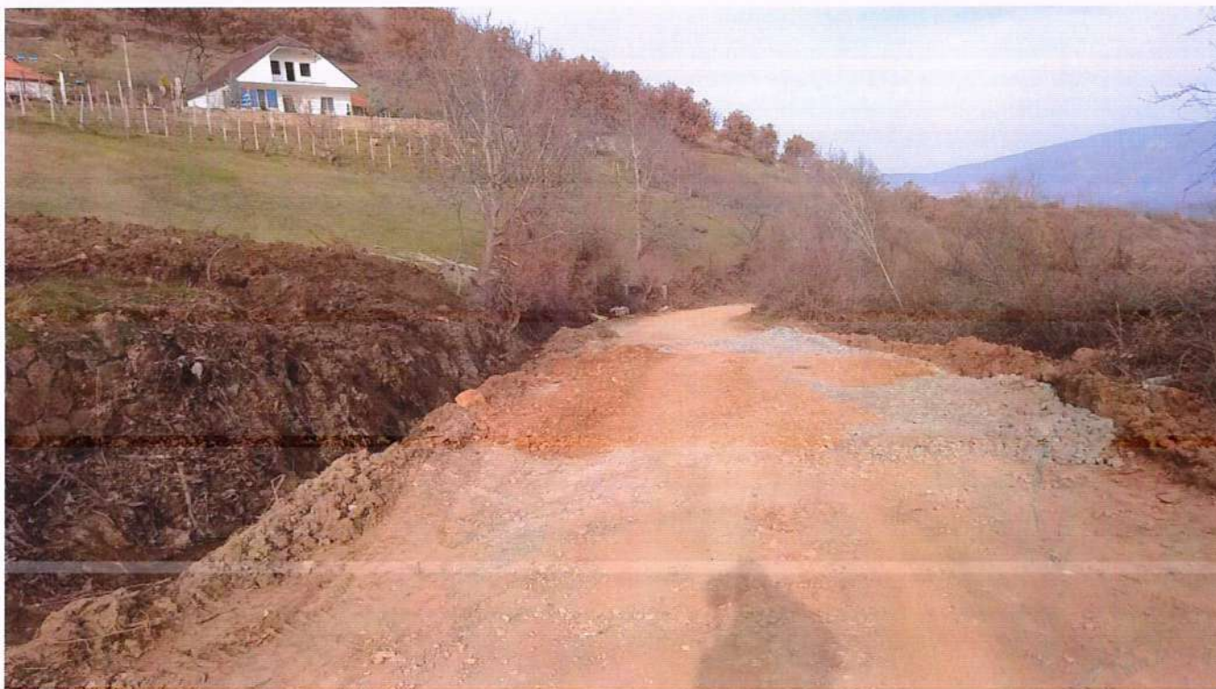
Figura 30 Gjendja ekzistuese e rruges
