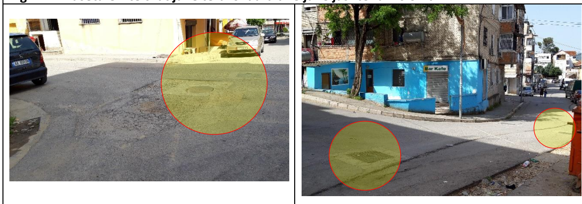
Fig. 1-22 Rrjeti i kanalizimeve të UZ (puseta) dhe dëmtimi i shtresave asfaltike ekzistuese
