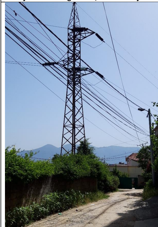
Fig. 1-31 Shtylla elektriku TN, në Prog.0+480
