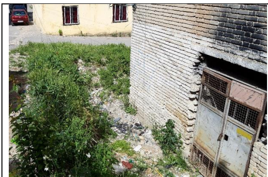
Fig. 1-30 Kabina elektrike në katin përdhe të objektit në Prog.0+120, krahu i majtë
