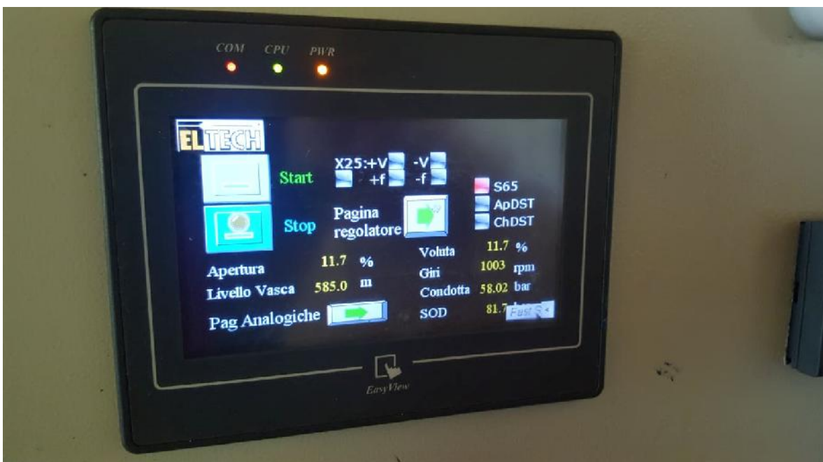
Pamje e te dhenave te presionit ne tubacion perpara hyrjes ne Turbinen Pelton (Qershor 2019)
