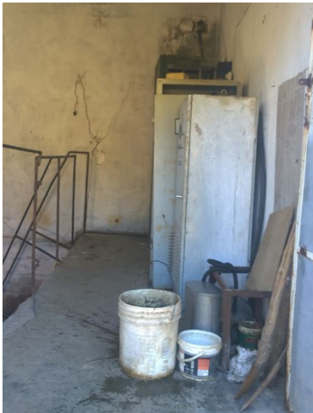
Fig.7 Panelet e leshimit te pompave stacioni pompave Mengel
