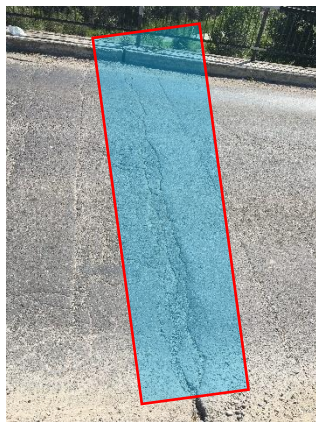
Dëmtim fugës ekzistuese
