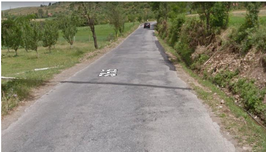
Figura 4: Gjendja ekzistuese e rruges
