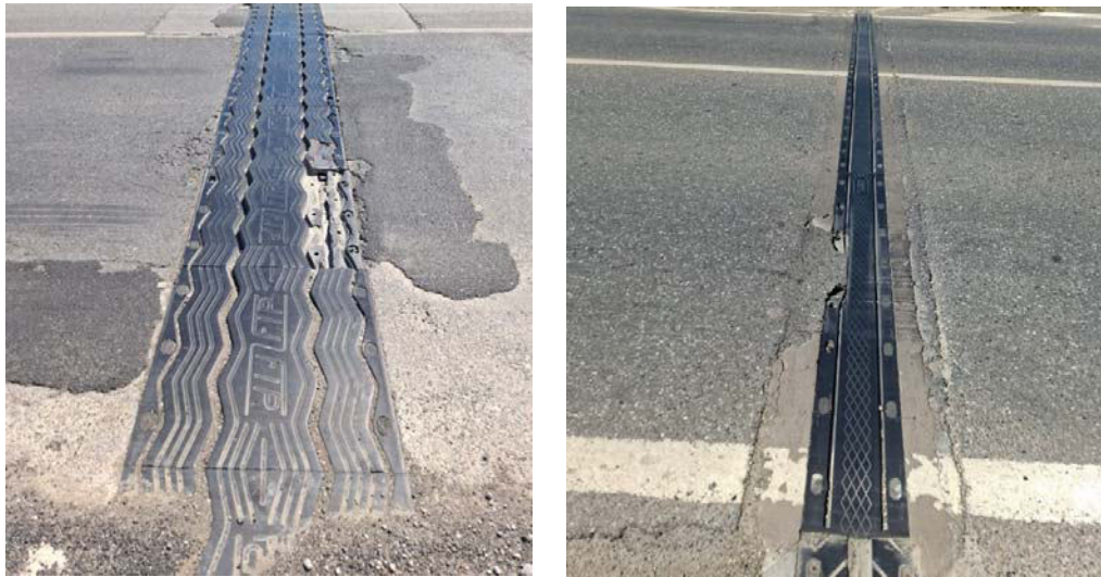
Foto të gjendjes aktuale të fugave të dëmtuar
