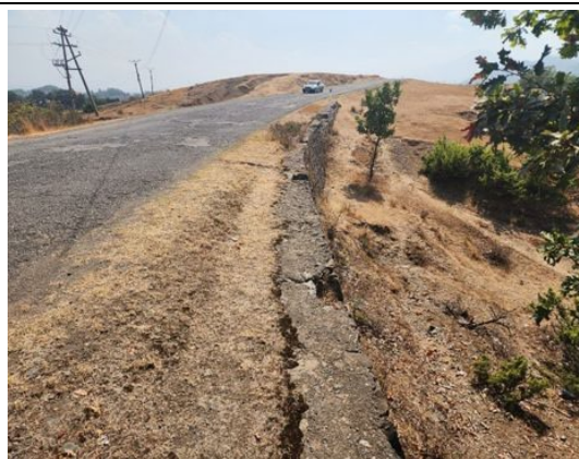
Foto A3.12 – Çarje gjatësore dhe cedim i skajit të rrugës
