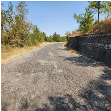
Foto A3.5 – Deformime dhe cedime pranë murit mbajtës
