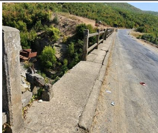
Foto A3.10 – Parapet i dëmtuar dhe kunetë e degraduar në urë
