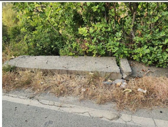
Foto A3.8 – Brez betoni i dëmtuar në murin mbajtës
