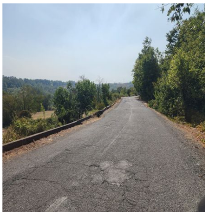
Foto A3.3 – Gropëzime dhe degradim i tapetit
