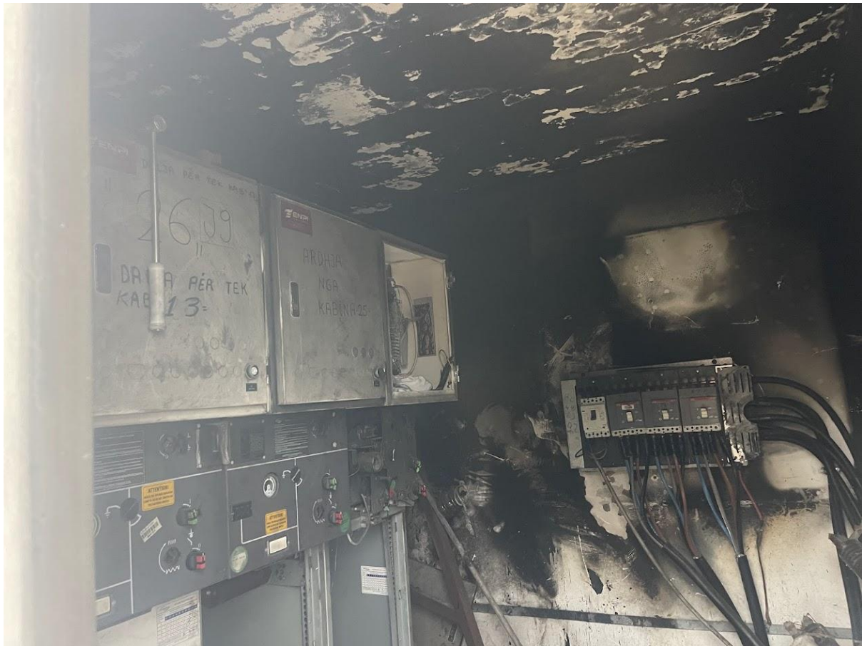
Kabina 26 J9 Celat e demtura, kabina shume problematike nga ana ndertimore
