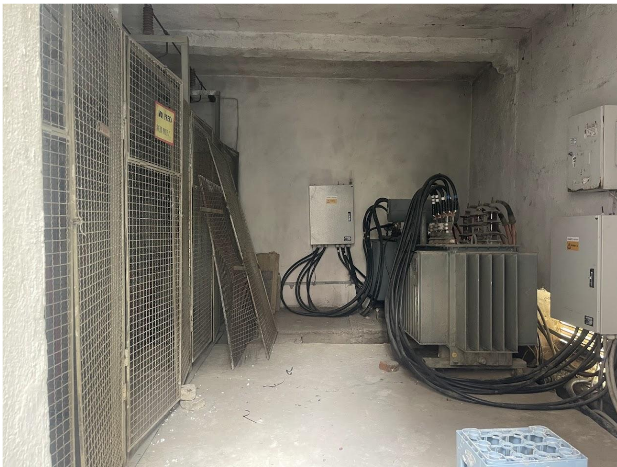
Bardhok Biba 1 Mungon rrethimi I transformatorit, Celat e demtuara
