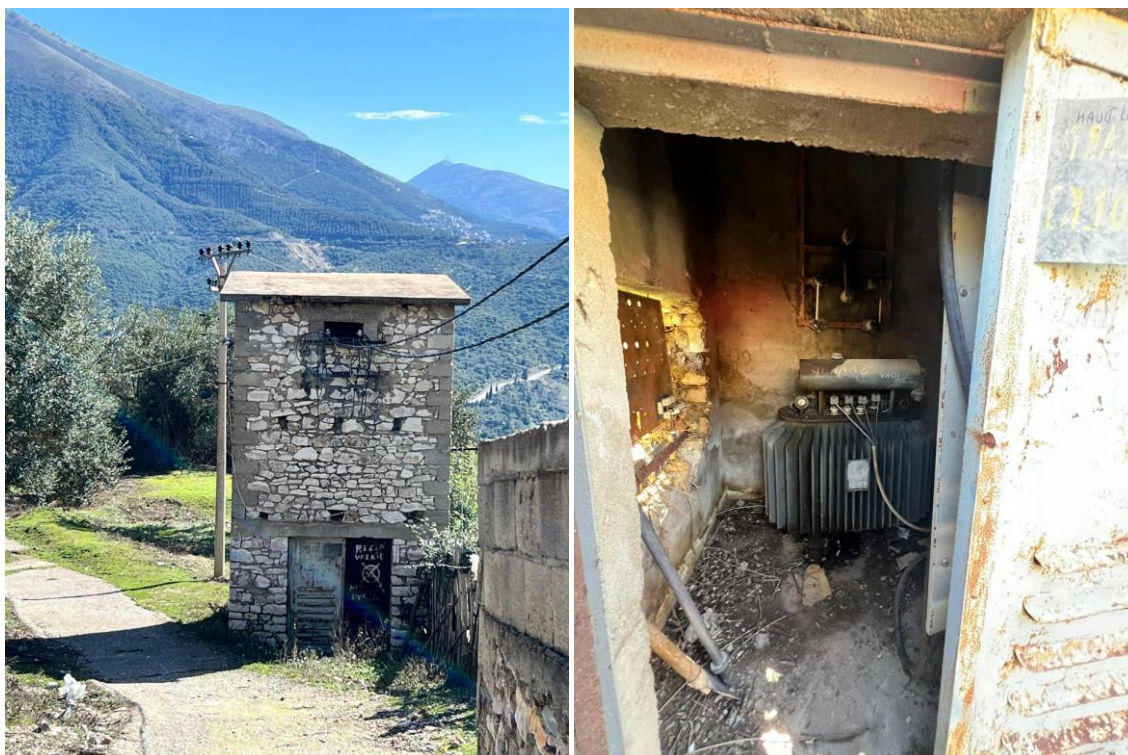
Figure 5 Kabina ekzistuese Piqeras
