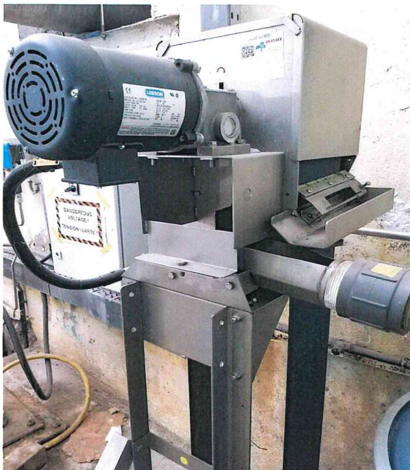
2- Foto te Impiantit te veçimit te vajit prane Pusit Nr.3 te Thellesise
