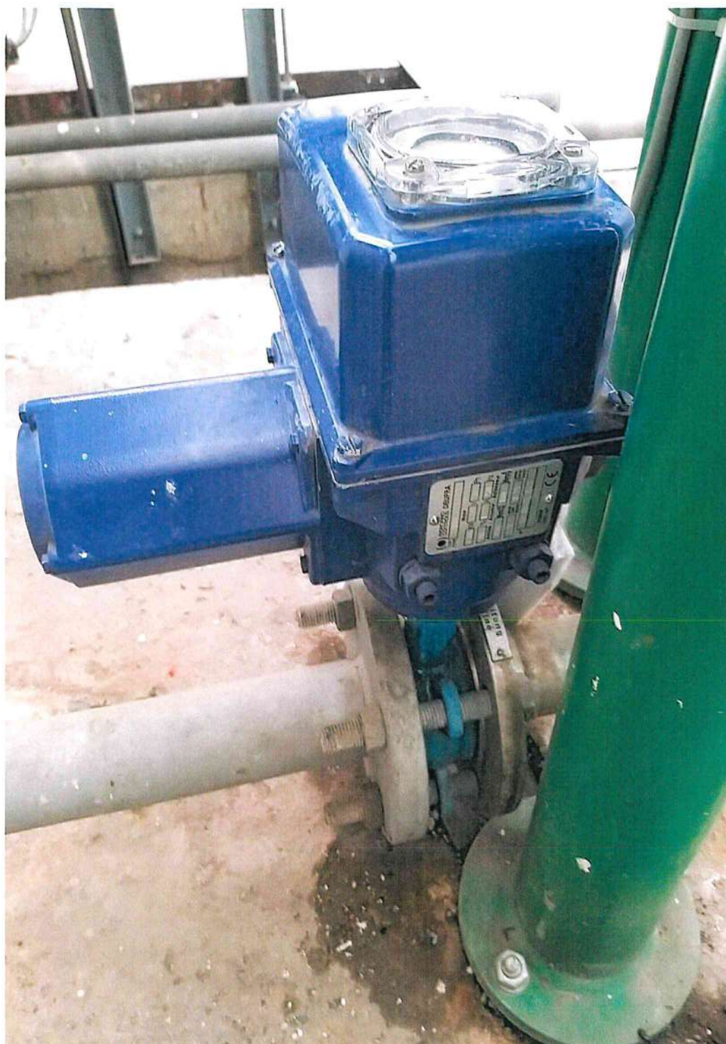
Pamje e Elektro -Valvules së shpëlarjes automatike te Filtrit "HYDAC", ne vend-montimin e saj
