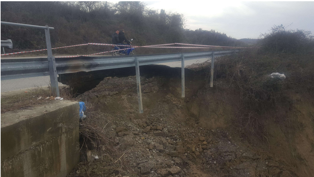
Foto 3, 4 Pamje e dy shkarjeve të para për gjatë rruges
