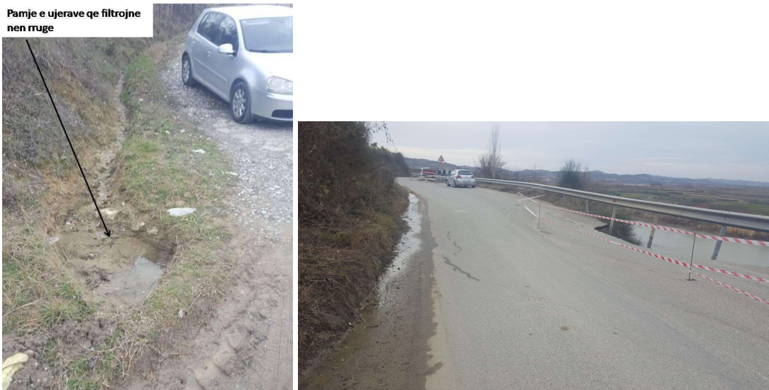
Foto 9. Pamje e infiltrimit dhe te qarkullimit te ujerave per gjate rruges
