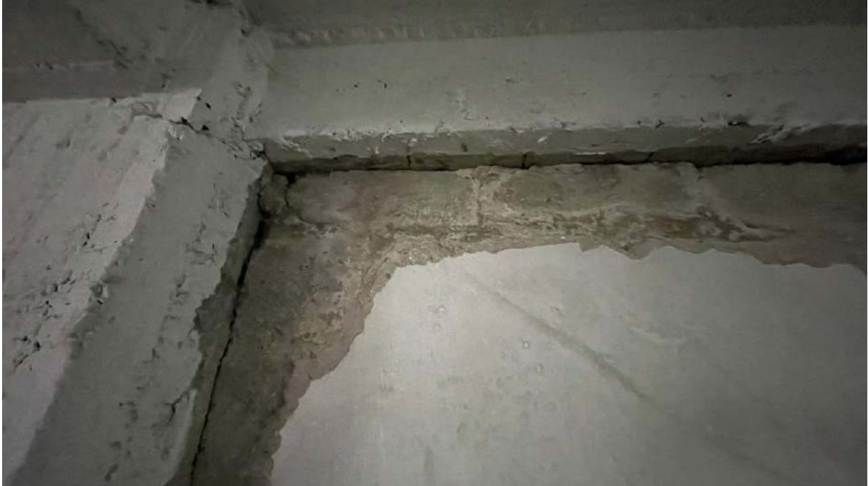
Foto 12. Dëmtime të mureve në podrum.
