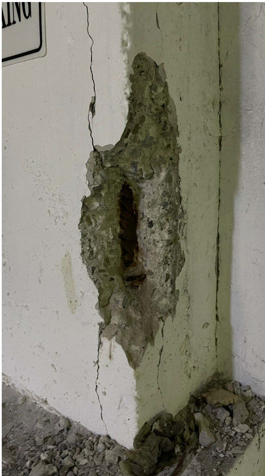
Foto 17. Dëmtime te kolones.
