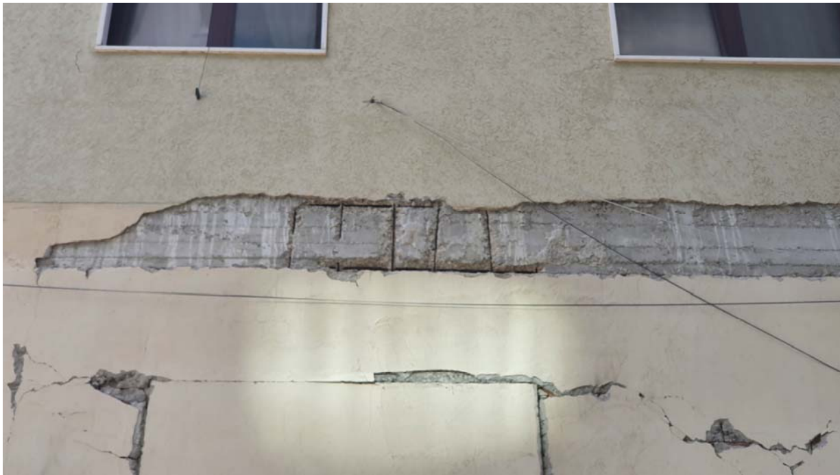
Foto 7. Dëmtime ne tra dhe murature.
