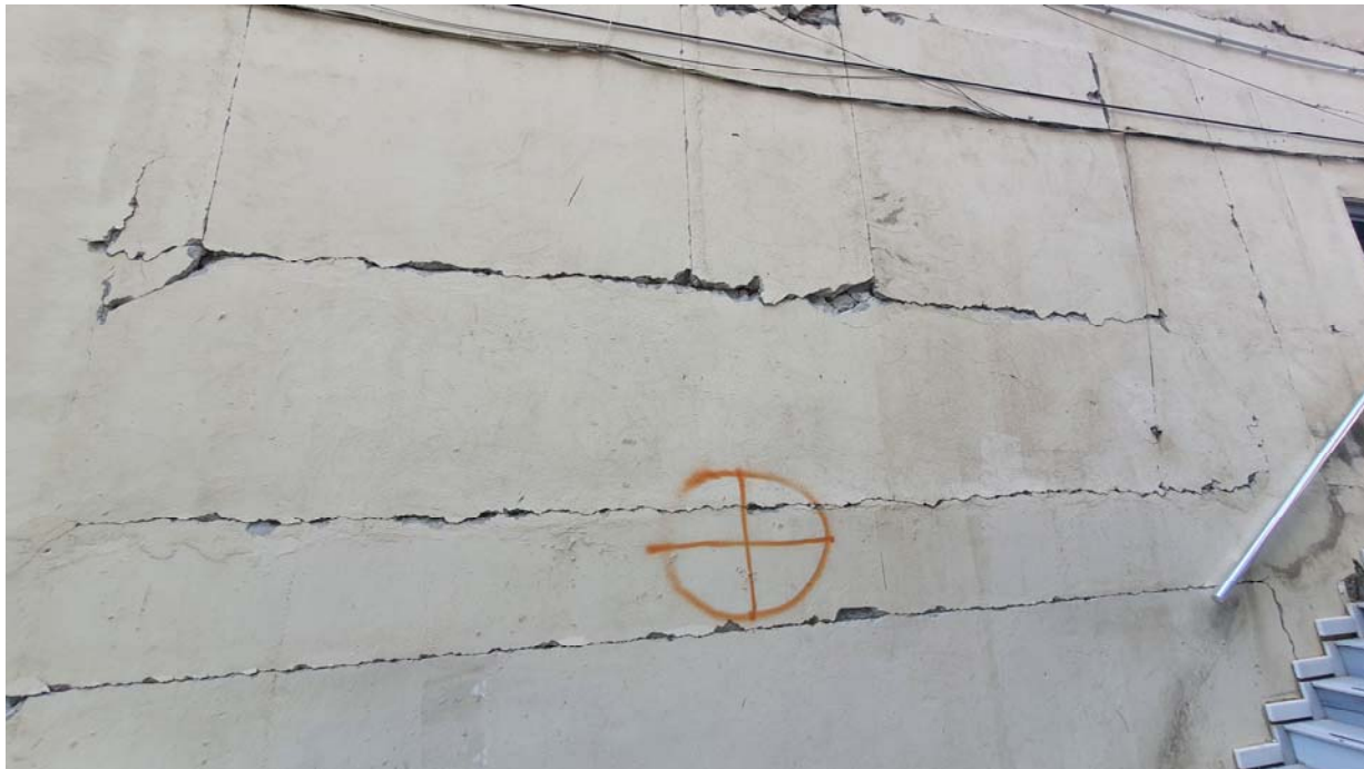
Foto 5. Dëmtime të mureve.
