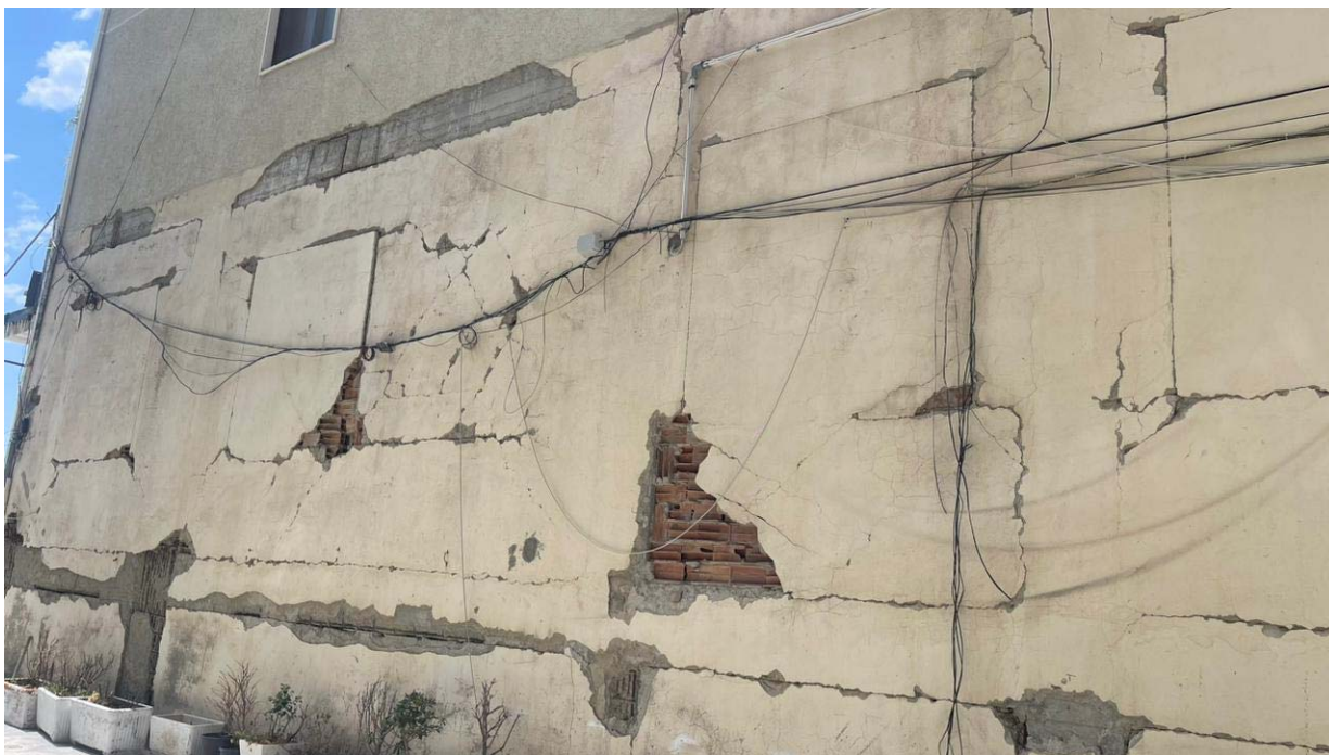
Foto 15. Dëmtime të muratës në katin përde të objektit.
