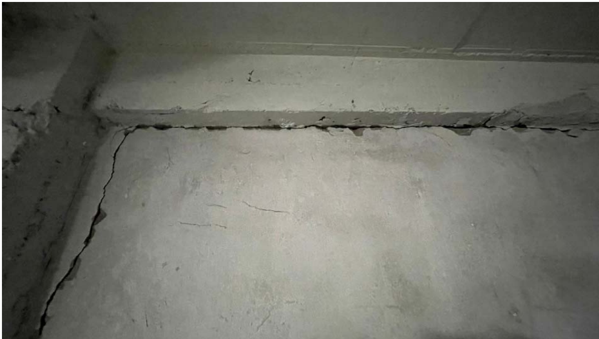
Foto 14. Dëmtime të mureve në podrum.
