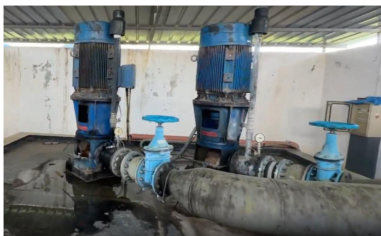
Figura 10: Pompat e stacionit nr.1 Frigorifer
