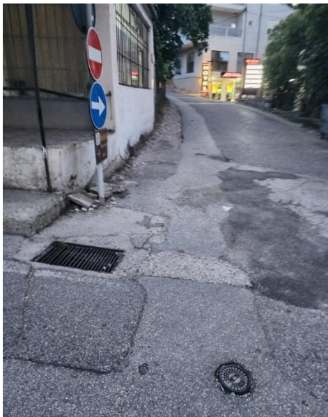
Figura 8, Gjendja e shtresës asfaltike Rruga Harillaq Liti
