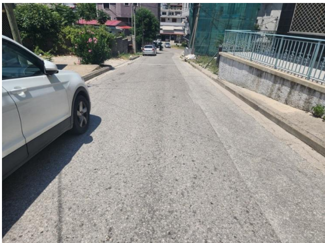
Figura 15, Gjendja e shtresës asfaltike Rruga Koco Kocollari
