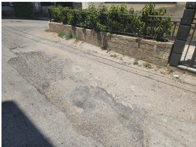
Figura 14, Gjendja e shtresës asfaltike Rruga Koco Kocollari
