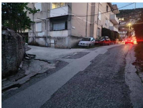
Figura 9, Gjendja e shtresës asfaltike Rruga Harillaq Liti
