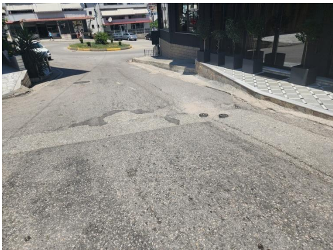
Figura 13, Gjendja e shtresës asfaltike Rruga Koco Kocollari
