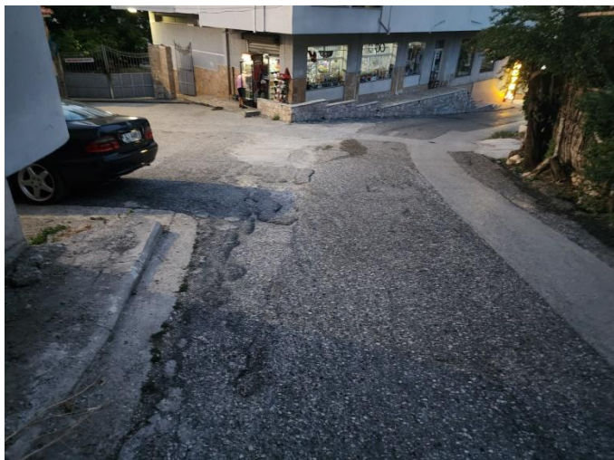
Figura 11, Gjendja e shtresës asfaltike Rruga Harillaq Liti
