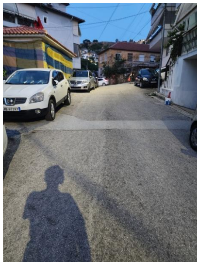
Figura 10 , Gjendja e shtresës asfaltike Rruga Harillaq Liti
