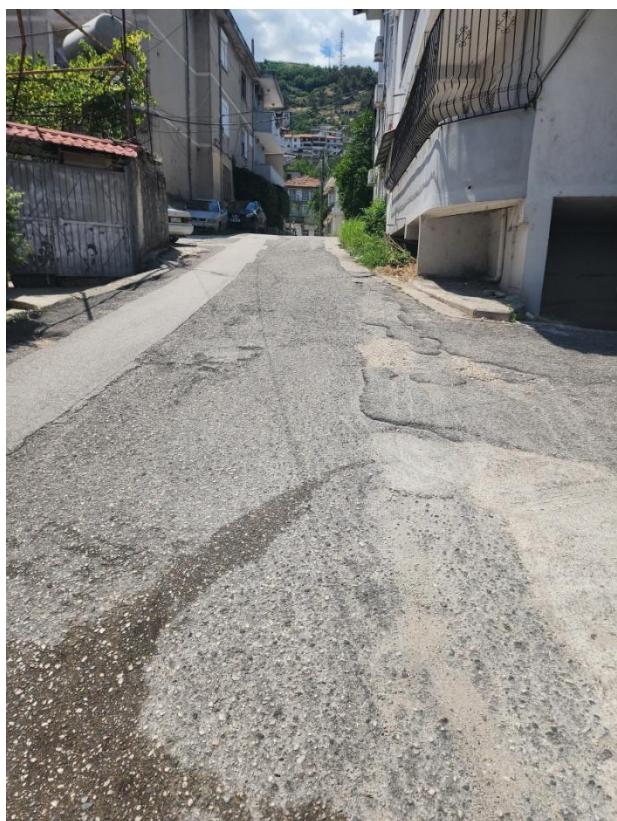
Figura 12, Gjendja e shtresës asfaltike Rruga Harillaq Liti
