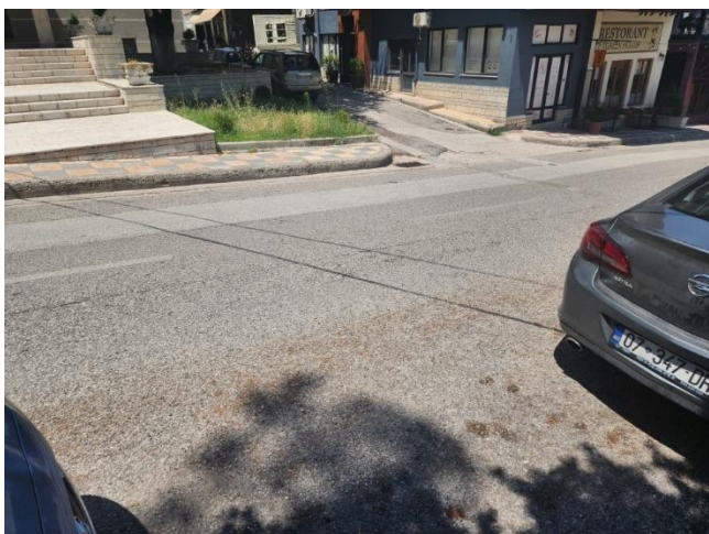
Figura 3. Pamje e karrexhatës me degradime dhe ndërhyrje të mëparshme në rrugën “Dr. Vasil Laboviti”.
