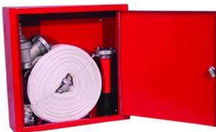
Figure 12, Pamje e hidrantit
