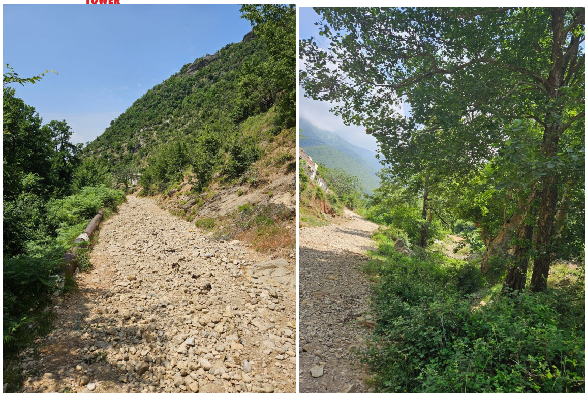
Figure 14 Tubacion celiku jofunksional +gjendja e rruges
