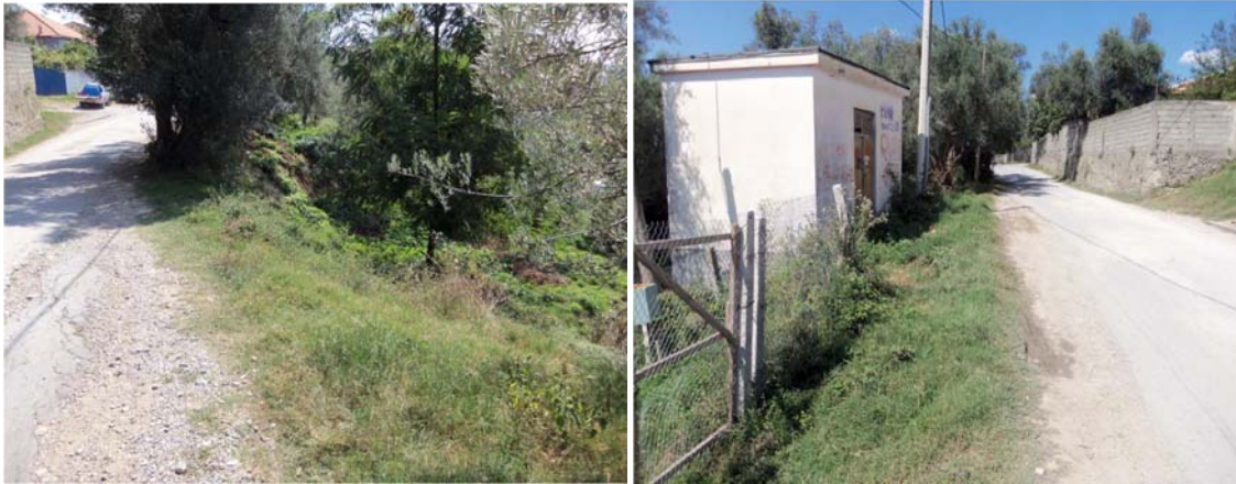
Figura 14 – Foto te zones ne km 0+525 ne te cilen eshte prezent fenomeni i rreshqitje
