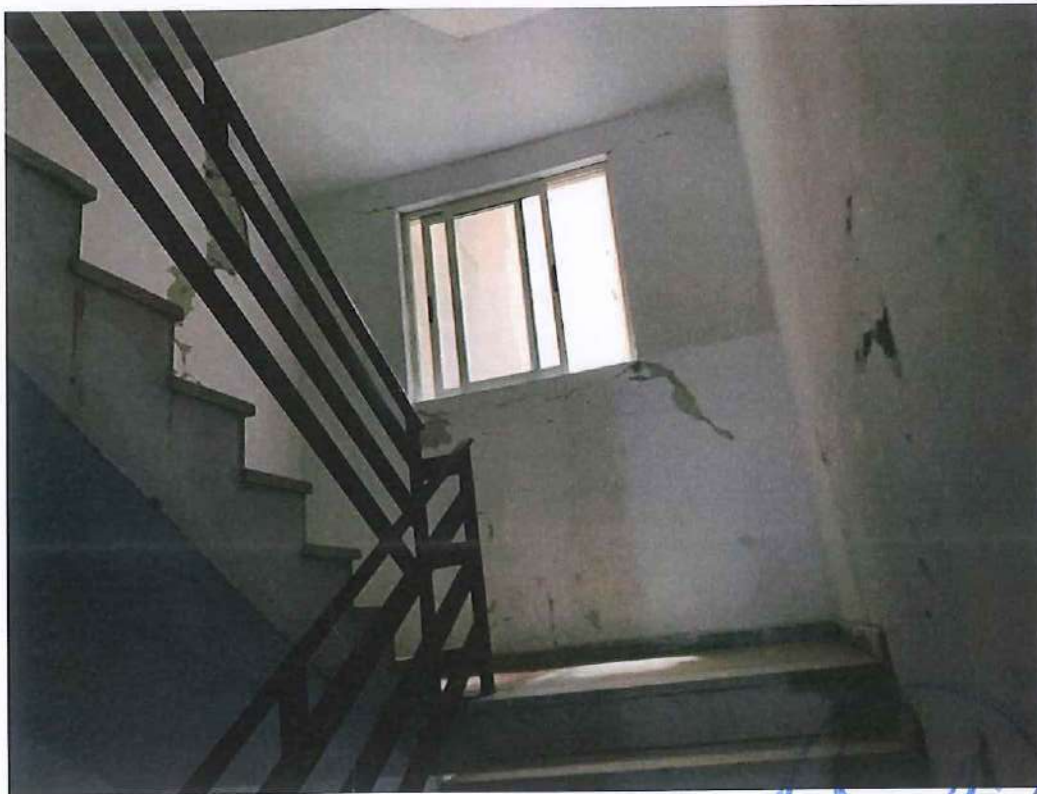
Foto 7. Plasaritje ne muret e kafazit te shkalleve te objektit.
