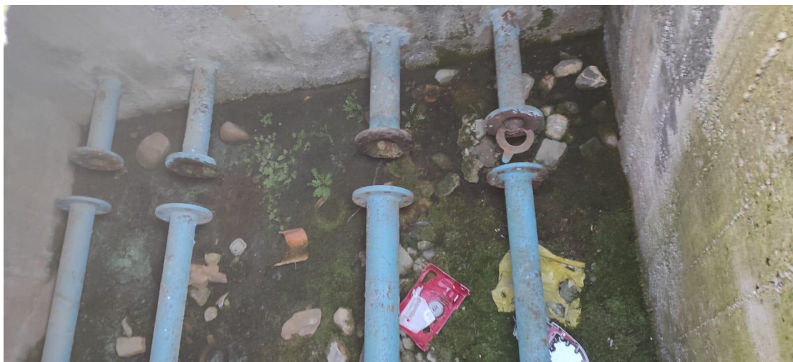
Figura 20: Detaj pusete manovrimi ne dalje te rezervuareve (mungese rakorderive)
