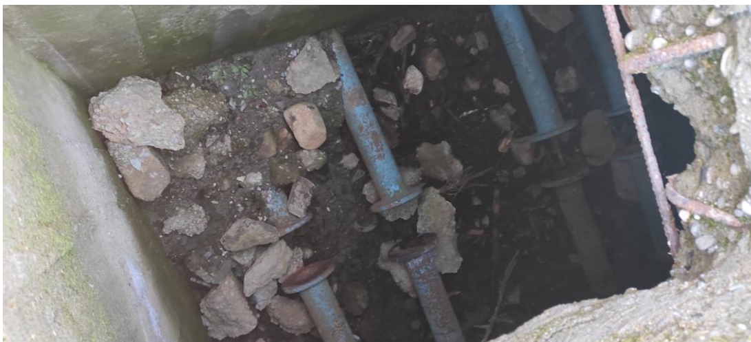
Figura 25: Detaj pusete manovrimi ne dalje te rezervuareve (mungese rakorderive)
