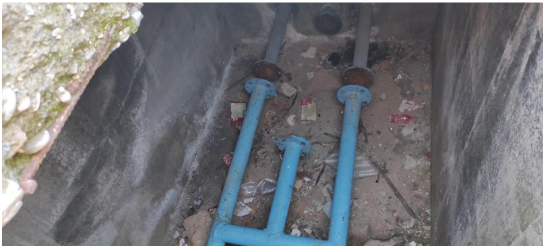
Figura 24: Detaj pusete manovrimi ne dalje te rezervuareve (mungese rakorderive)
