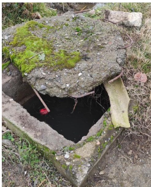
Figura 32: Foto pusete manovrimi fshati Majtare (e permbytur)
