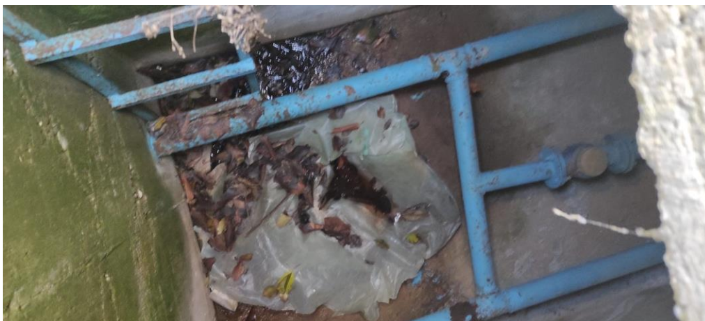
Figura 13: Pusetat manovrimi ne hyrje te rezervuareve
