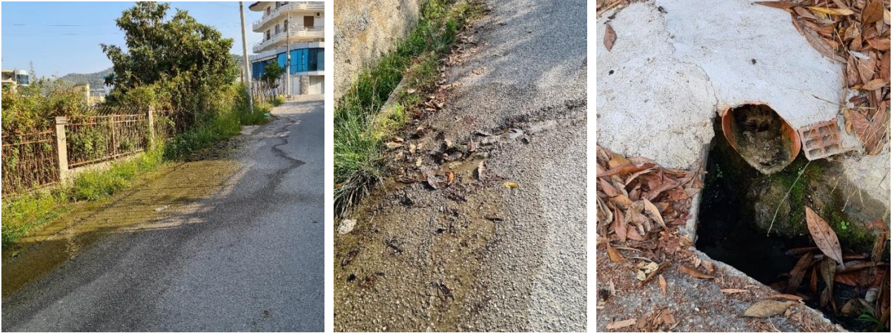
Figura 5.4 Demtimet e tubacionit si dhe daljet ne siperfaqe te linjes ne rrugen "Azem Sulo"
