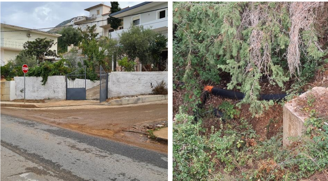
Figura 5.5 Rrjedhje ne siperfaqen e rruges Dhimiter Konomi (majtas) Tubacione ne siperfaqe lagjja poshte rr. Dhimiter Konomi (djathtas)
