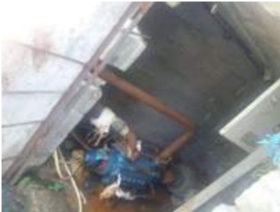
Figure 4-15: Godina Egzistuese e Stacionit te Pompave ne Fshatin Picar
