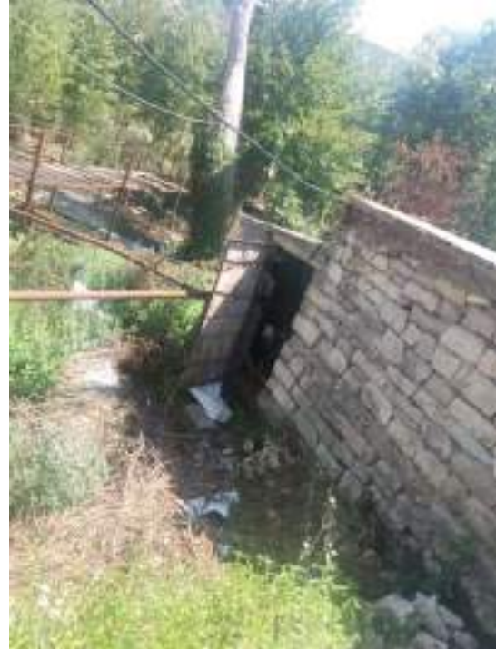
Figure 4-14: Godina Egzistuese e Stacionit te Pompave ne Fshatin Picar
