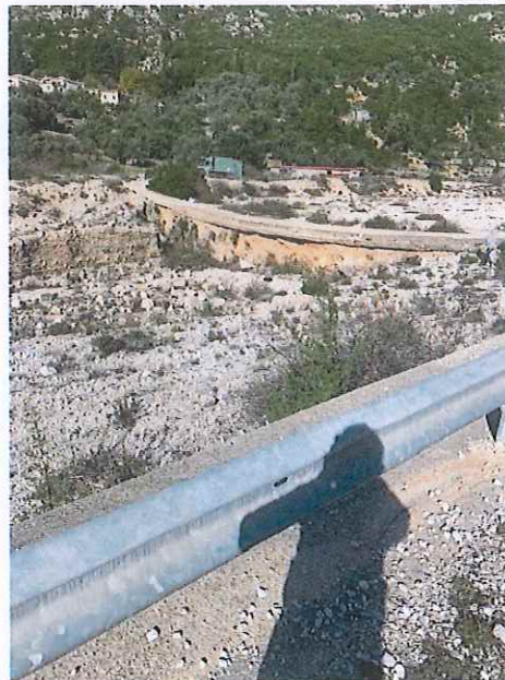
Prita Malore ne Progresiven 0+560, eshte e demtuar ne bjefin e poshtem.
