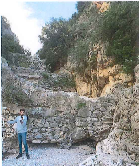
Pritat malore ekzistuese, ne Progresiven 0+860 jane demtuar ne bjefin e poshtem, eshte gerryer bazamenti.
