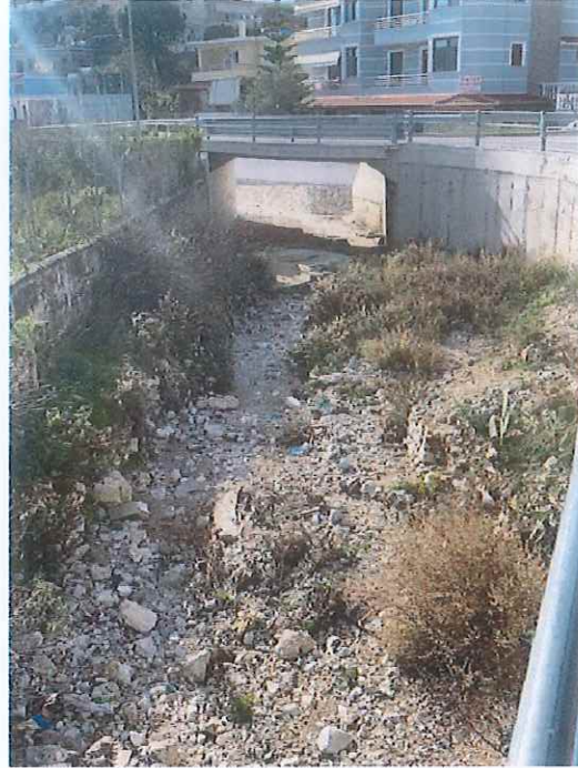
Progresiva 0+380 fillon perroi i pa sistemuar. Ka mure betoni here majtas dhe here djathtas ne varesi te ndertimeve qe jane bere ne zone.
