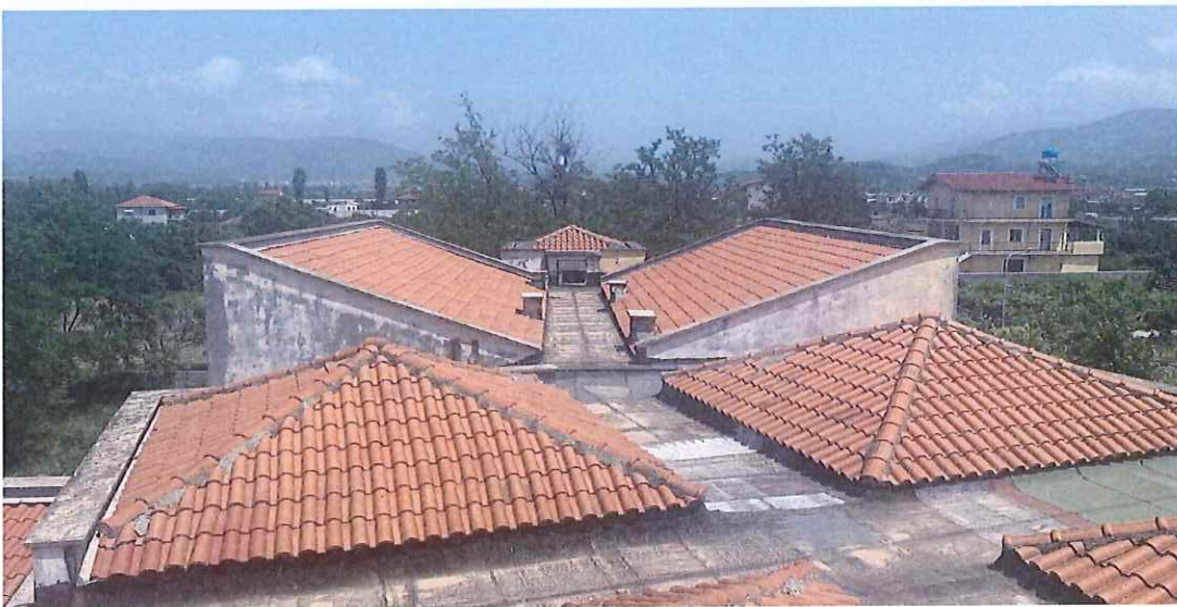
Foto te gjendjes ekzistuese te hidroizolimit dhe lageshtia
