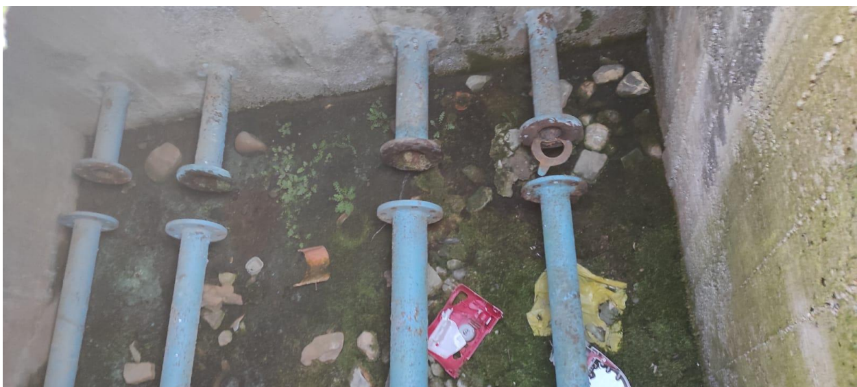
Detaj pusete manovrimi ne dalje te rezervuareve (mungese rakorderive)
