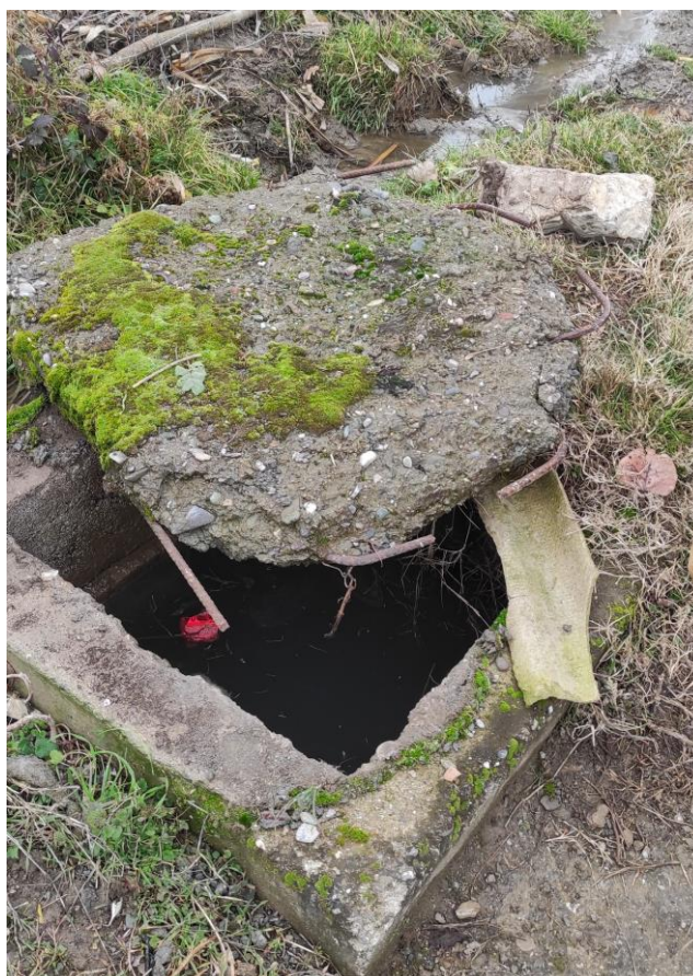
Foto pusete manovrimi fshati Majtare (e permbytur)
