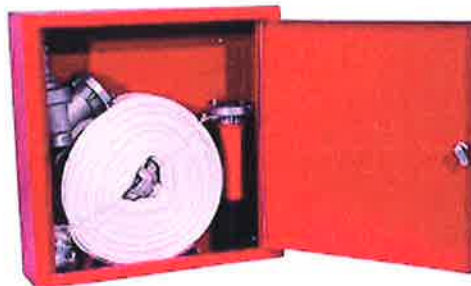
Figure 10, Pamje e hidrantit
